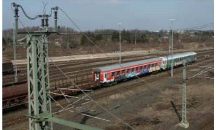
Nördlich der Straßenbrücke wird das neue Ladeterminal von der NVAG gebaut Foto: Bubach-Bernhardt
