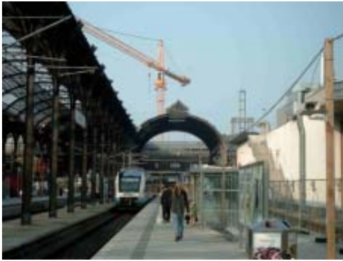
Gleise 1 und 2 ohne Dach: Hier wurde die Halle bereits abgetragen. Gleis 1 rechts immer noch gesperrt Foto: Brandt
